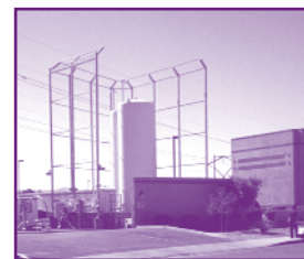
LNG fueling station
